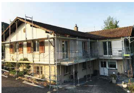
Vorher: Das in die Jahre gekommene Wohnhaus in Gelterkinden musste umfassend saniert werden. Insbesondere der Zustand des Dachs und des Estrichs liessen zu wünschen übrig.
