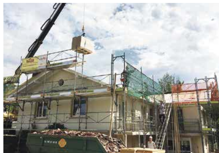
Während der Arbeiten: Die Ritter Bedachungen-Zimmerei-Spenglerei hat alles für die Sanierung des Dachs sowie die Spenglerarbeiten vorbereitet, die alten Ziegel wurden abgetragen.
